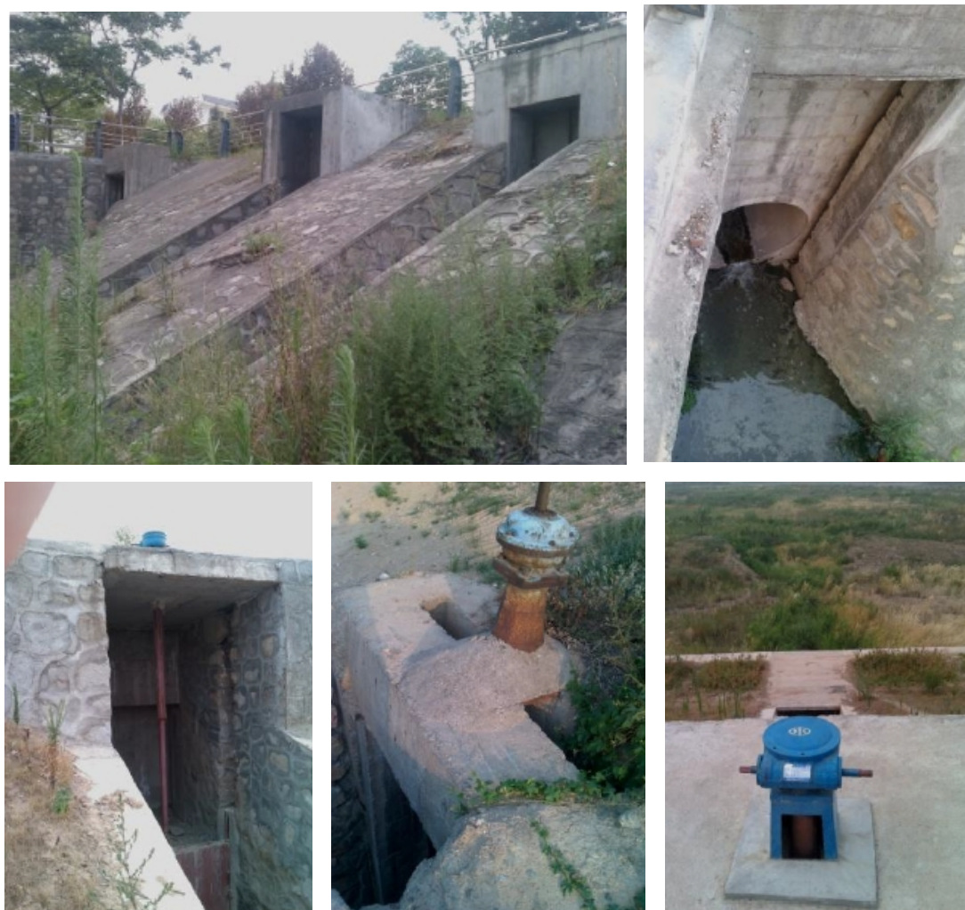
图 3-5 宝鸡市部分雨水排放口现状图
